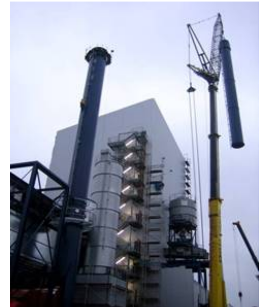
Emlichheim – in Betrieb seit 31.3.2006
